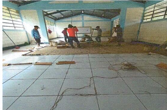
Foto 2: Colocación de piso cerámico en el aula de tercero y sexto primaria.
